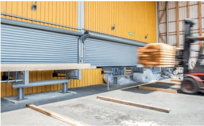
Im Sägewerk: Zwei Rolltore bieten reichlich Platz für den Durchtransport von sehr breiten Hölzern. Sie sind zudem an die Steuerungstechnik der bauseitigen Förderysteme angebunden.
