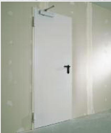
Eingesetzte Feuerschutztür mit Obentürschließer.
