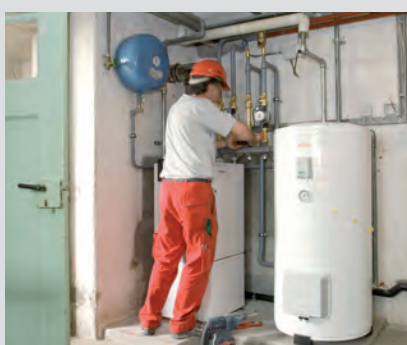
Wärmespeicherung Heizungsinstallateurinnen und -installateure können Heizwasserspeicher und ähnliche Geräte installieren und an das Leitungsnetz anschließen.
