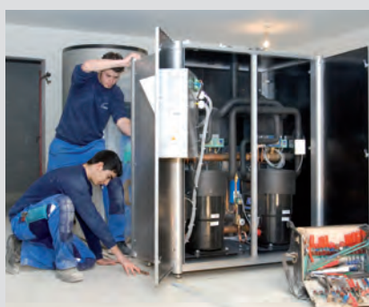
Die Wärmeerzeugung – das Herz der Heizung Die Entwicklung neuer Heizsysteme verlangt Lernbereitschaft. Die Berufsleute kennen zum Beispiel Wärmepumpen und können mit ihnen umgehen.
