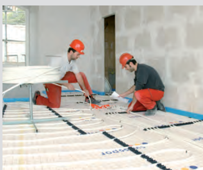
Verlegen der Bodenheizung Die Bodenheizungsrohre werden auf die zuvor verlegten Dämmplatten in Schlangen genau nach Plan verlegt.
