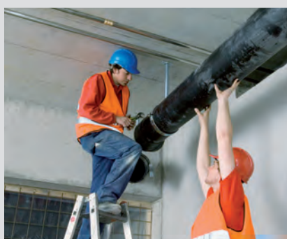
Montage von Rohrleitungen Zu den wichtigsten Aufgaben der Berufsleute gehört die Montage der Heizungsrohre, von Apparaten, Geräten und Armaturen.
