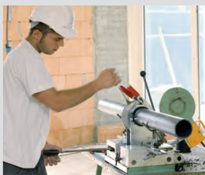
Arbeit an der Werkbank An der Werkbank fertigen die Sanitärinstallateurinnen und -installateure spezielle Rohrverbindungen an. Im Bild die Arbeit am Schweissspiegel.
