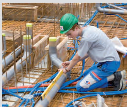
Einlegearbeit im Rohbau Noch während des Rohbaus verlegen die Berufsleute die Leitungen etwa für Abwasser auf die untere Eisenarmierung der Decke. Diese Arbeit ist anstrengend.
