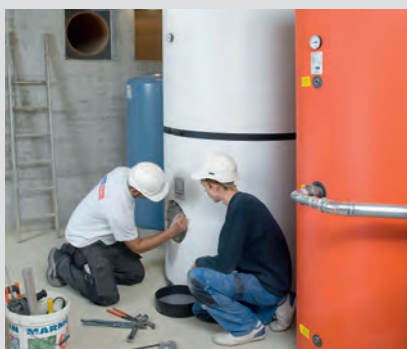
Inbetriebnahme eines Wassererwärmers Der Anschluss, die Überprüfung und die Inbetriebnahme eines Wassererwärmers gehören zu den vielfältigen Aufgaben.
